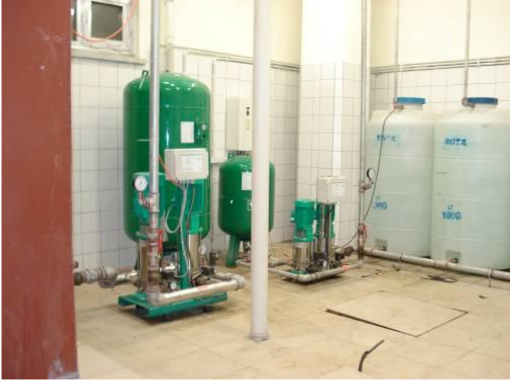
Su depoları ve arıtma sistemi
